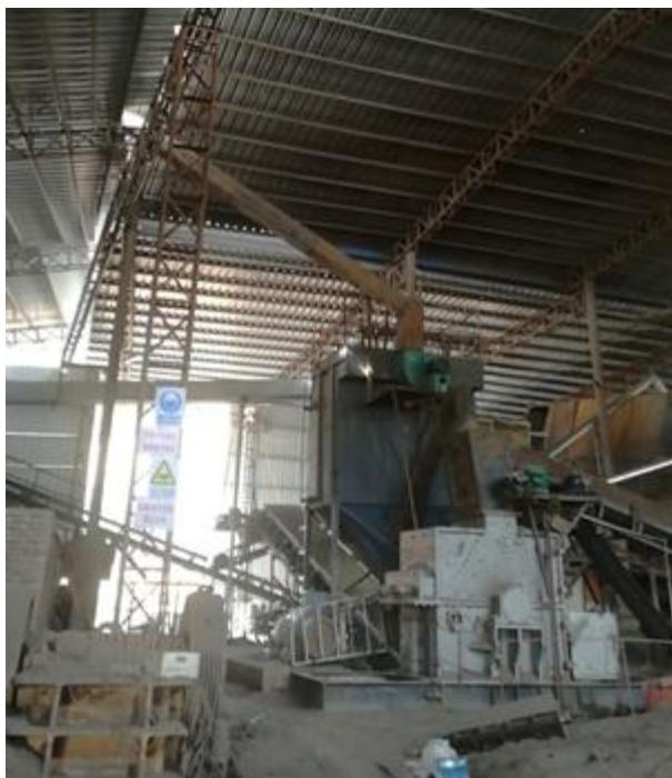
图 4.2-1 布袋除尘器现场照片
