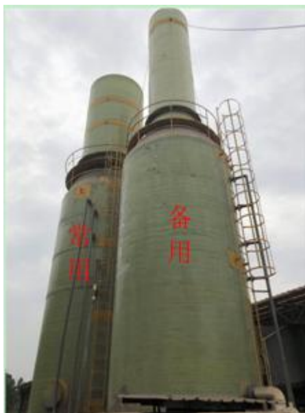
图 4.2-2 钠碱双碱法脱硫除尘设备现场照片
