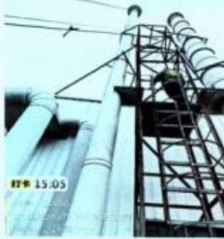
DA007 废气处理后采样口
