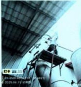
DA010 废气处理后采样口
