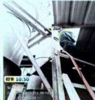
DA005 废气处理后采样口
