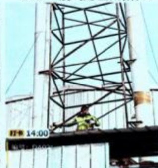
DA021 废气处理后采样口
