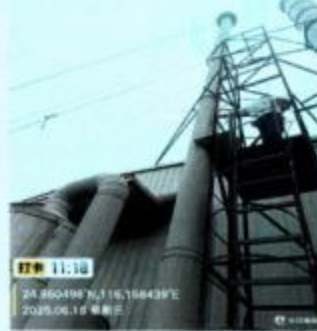
DA007 废气处理后采样口
