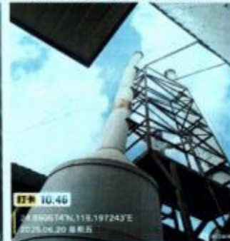
DA023 废气处理后采样口
