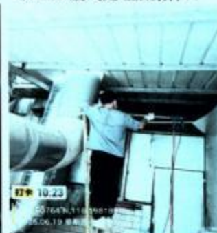
DA006 废气处理后采样口
