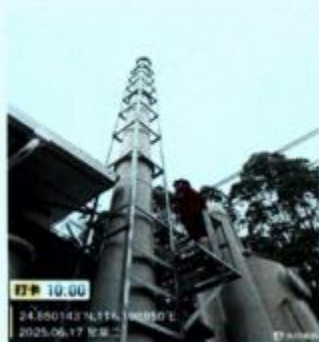
DA048 废气处理后采样口
