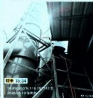
DA005 废气处理后采样口
