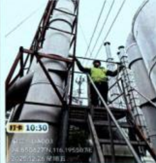
DA003 废气处理后采样口
