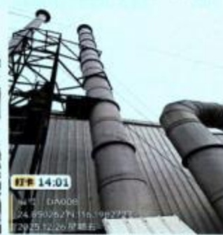
DA008 废气处理后采样口
