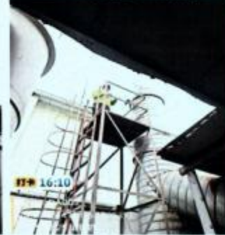
DA009 废气处理后采样口
