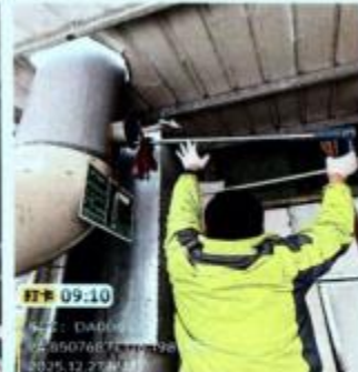
DA006 废气处理后采样口
