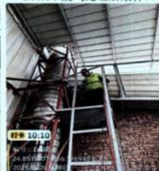
DA034 废气处理后采样口
