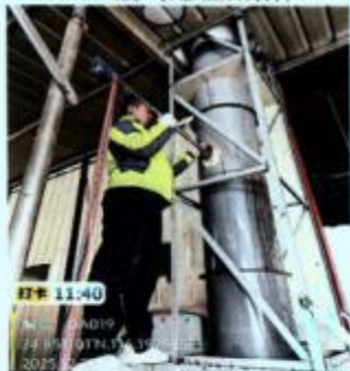
DA019 废气处理后采样口
