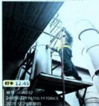
DA032 废气处理后采样口
