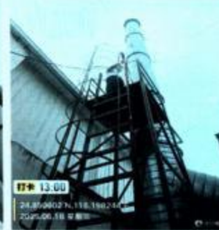
DA009 废气处理后采样口
