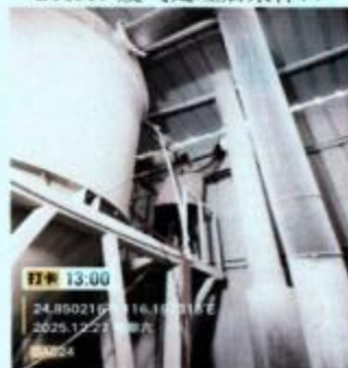
DA024 废气处理后采样口
