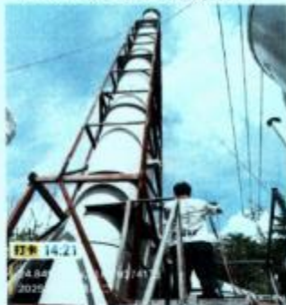
DA004 废气处理后采样口
