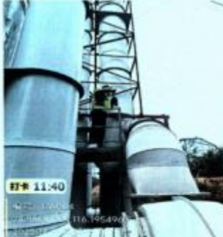
DA004 废气处理后采样口
