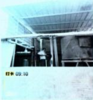
DA001 废气处理后采样口
