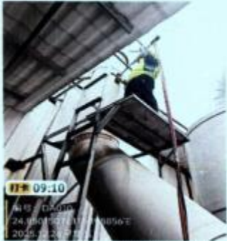
DA010 废气处理后采样口
