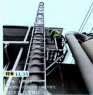
DA048 废气处理后采样口
