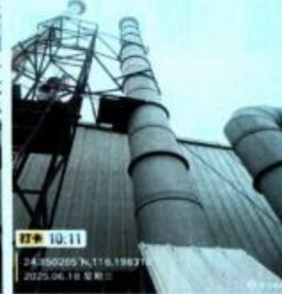
DA008 废气处理后采样口
