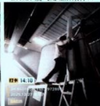
DA025 废气处理后采样口
