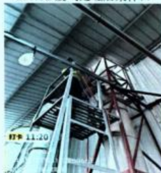
DA035 废气处理后采样口
