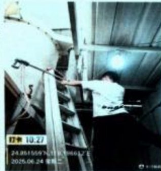
DA002 废气处理后采样口
