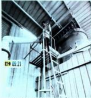
DA028 废气处理后采样口
