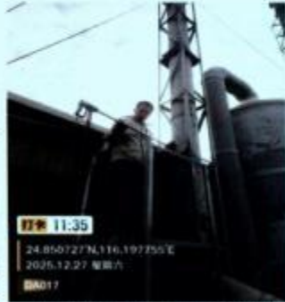
DA017 废气处理后采样口
