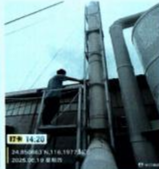
DA017 废气处理后采样口
