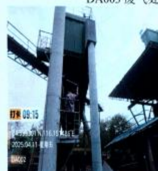
DA002 废气处理后采样口
