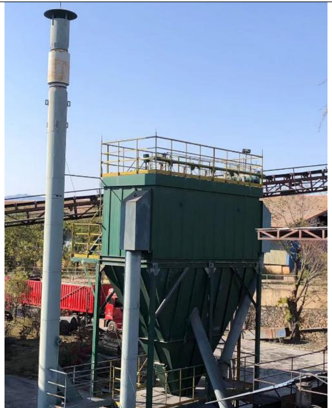
脉冲除尘器、15米高排气筒DA002
