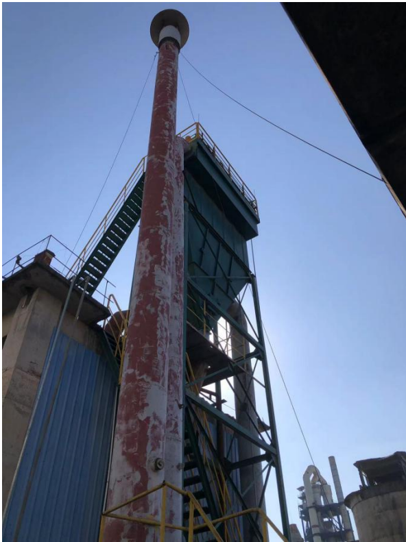
脉冲除尘器、15米高排气筒DA001
