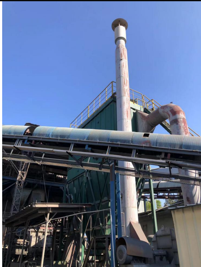
脉冲除尘器、15米高排气筒DA003
