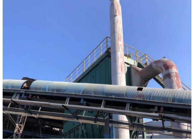
脉冲除尘器、15米高排气筒
